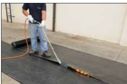
2. Dopo aver provveduto all'accensione del cannello, infilare la ciabatta saldagiunte al di sotto della seconda membrana, sfiammando e tirando verso se stessi
